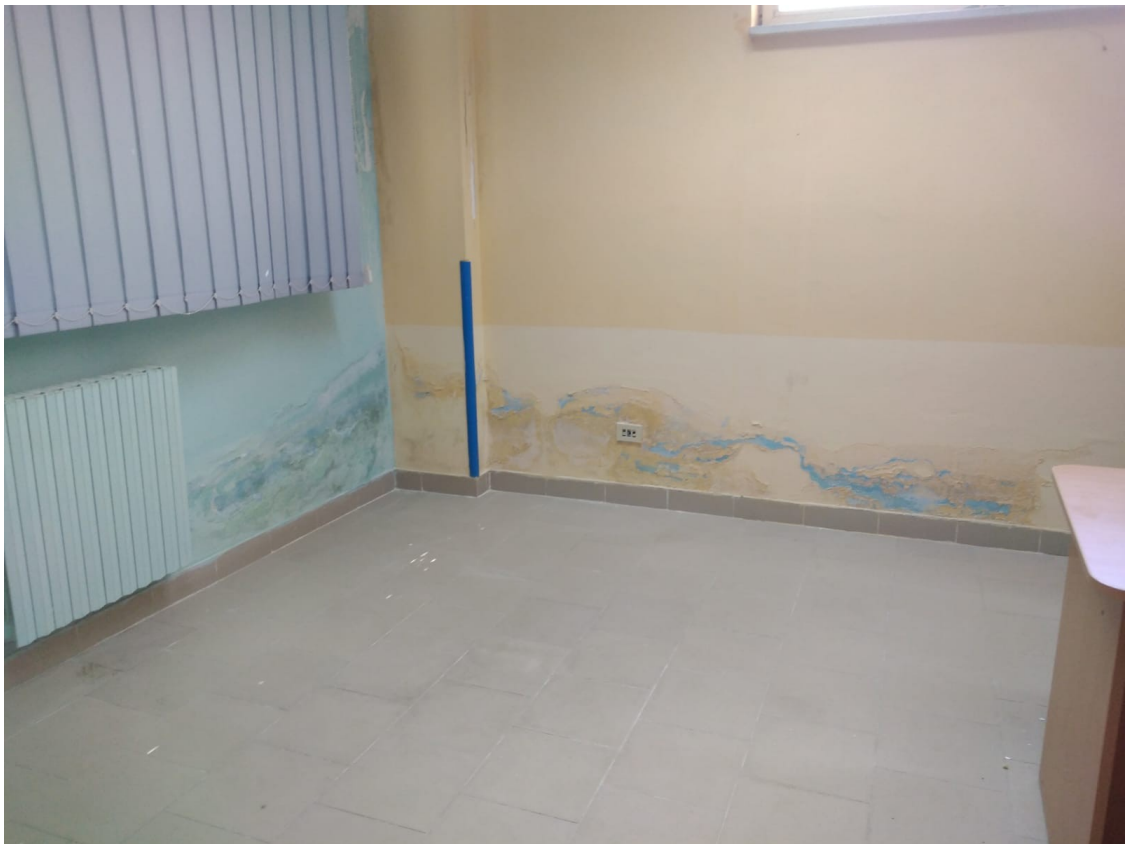
Figura 3: pareti del locale spogliatoio
