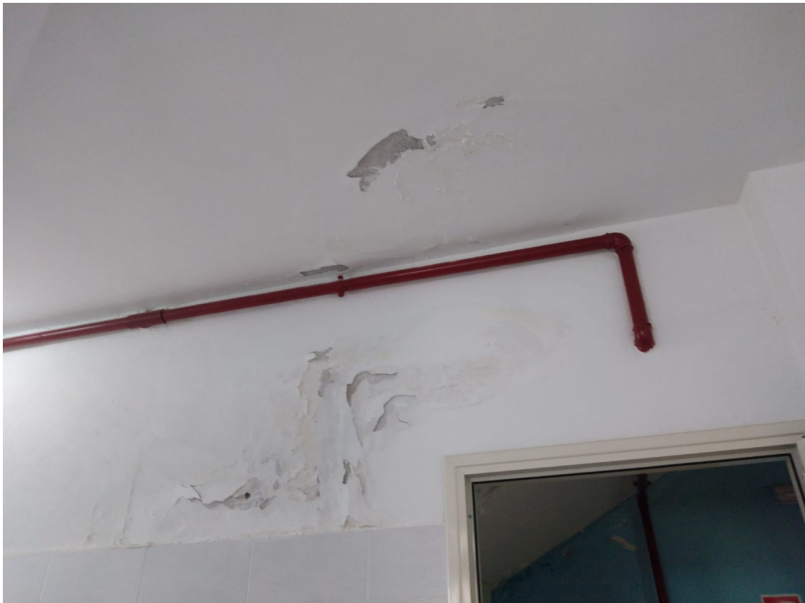
Figura 17: parete e solaio del locale bagno - zona ingresso
