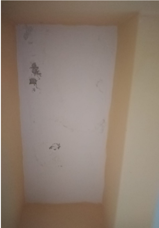
Figura 16: solaio ingresso sala psico-motorio
